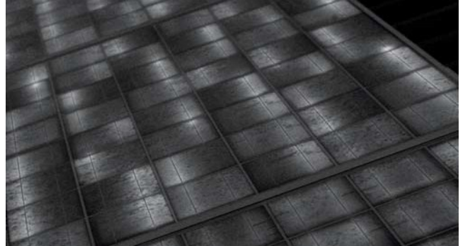
Bu fotoğrafta panel üzerindeki hücrelerde hot spots'lardan dolayı yüksek rezistansa (dirençli) sahip güneş panelleri gösterilmektedir.
